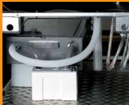
Nettoyez le siphon, la neutralisation* et la pompe à condensats*
