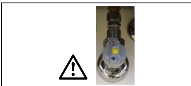
Bild: Gasanschluß Gefahr von Vergiftung und Explosion durch ausströmendes Gas
