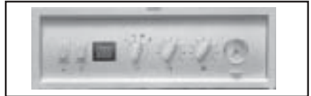
Bild: Gesamtansicht Regelung
