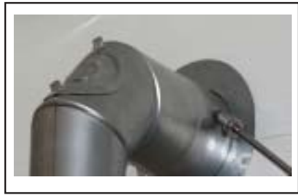
Bild: Abgasmessung TGU(K)
