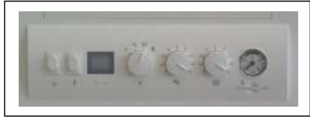
Bild: Gesamtansicht Regelung
