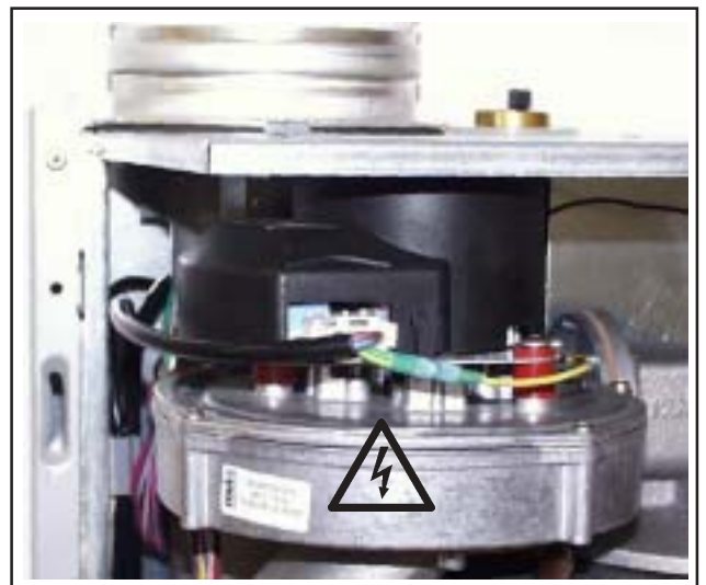
Bild: Gebläsestecker: Gefahr durch elektrische Spannung
