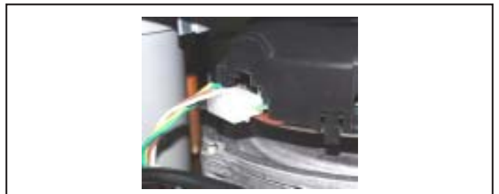
Bild: Steuerleitung zum Ventilator
