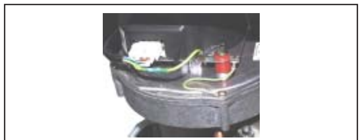
Bild: Versorgungsleitung und Erdung zum Ventilator
