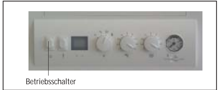
Bild: Gesamtansicht Regelung
