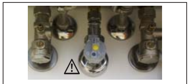
Figura: attacco gas: pericolo di intossicazione e di esplosione per fuoriuscita di gas
