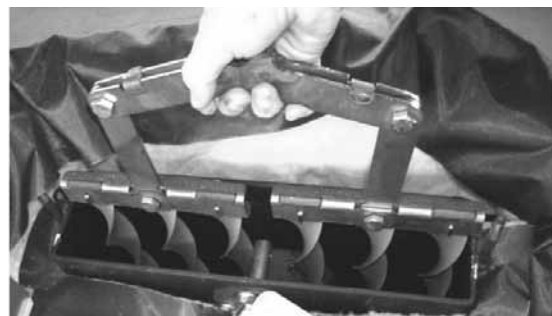
Turbulatoren (13) herausheben und reinigen
