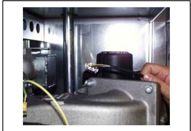
Bild: Alle elektrischen Anschlüsse lösen am Gebläse und Zündtrafo
