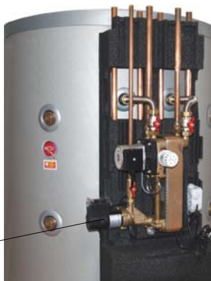
Module de circulation monté sur le module d'eau fraîche
